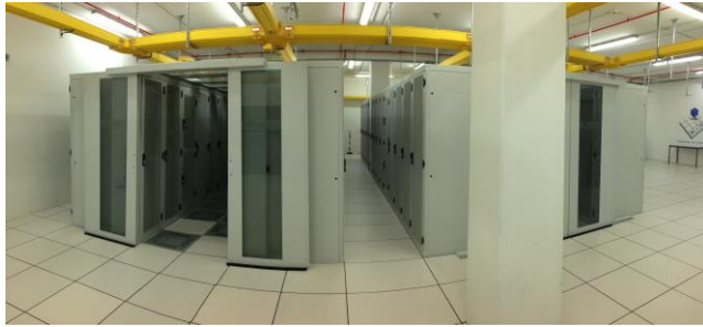
Photo du Datacenter de Nantes
